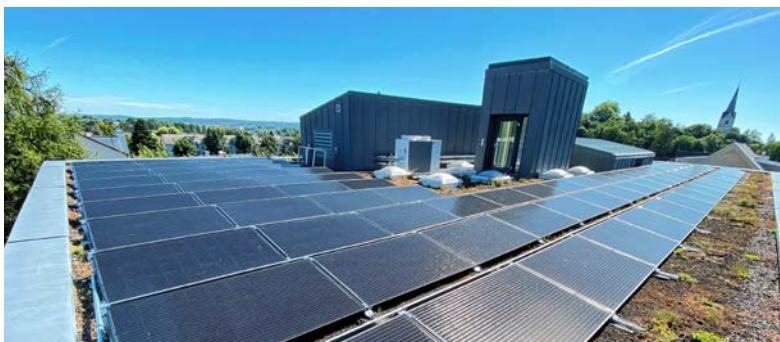
Dank der neuen Photovoltaikanlage auf dem Dach des Hauptgebäudes in Tägerwilen reduziert die Raiffeisenbank Tägerwilen den CO2-Ausstoss um zehn Tonnen pro Jahr. Bilder: zvg
